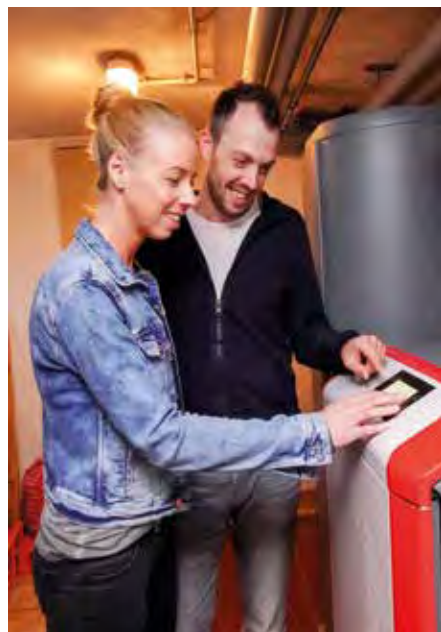
Pelletsheizung Familie Setznagl-Friesenbichler aus Dienersdorf
